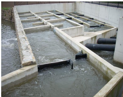
De vistrap bij de waterkrachtcentrale in Roermond (Nederland) (Foto: Johan Coeck)
